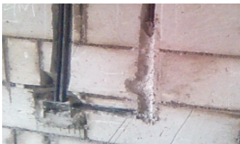
Electric Conduits & Junctions
